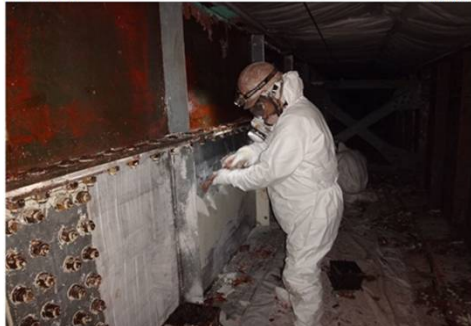
有害物質含有既存塗膜 掻き落とし作業状況② 電動ファン付き呼吸用保護具装着
