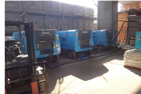
発電機 (エンジン式)
