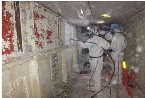
水系塗膜剥離剤 スプレー塗付作業状況 エアラインマスク装着
