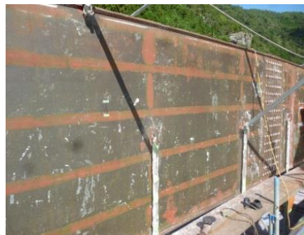
剥離後の残存塗膜
